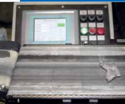
Kommunikation mit der S7-Steuerung
